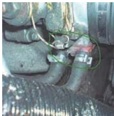
شکل ۶۱- نشتی از لوله ها و پولک اطراف سیلندر
